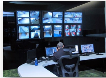
Las Tablas control room
